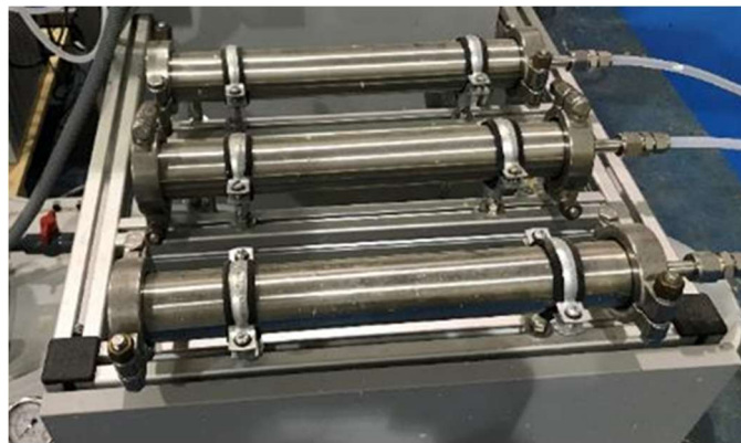
Fig. 6 RO membranes pilot plant.
